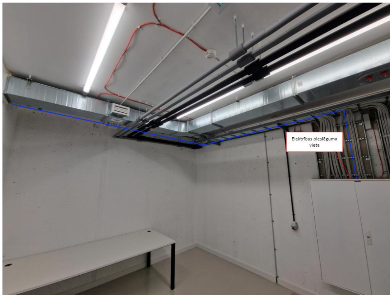
Elektrības pieslēguma vieta 2.stāva sadales telpā Nr.251
